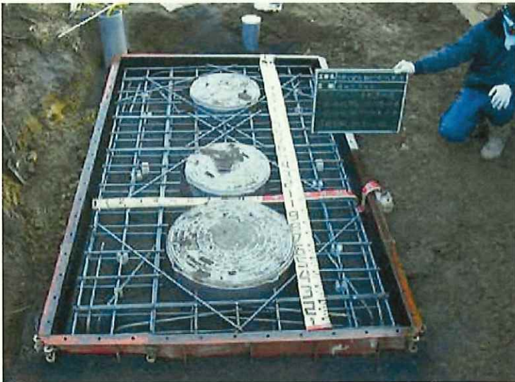
工事写真12 上部スラブコンクリートの配筋状況を示す写真
